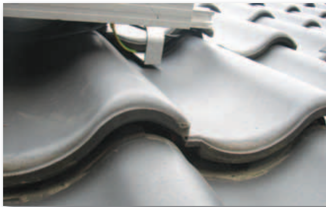
Kierende dakpannen door de beugels van het zonnepaneel.
