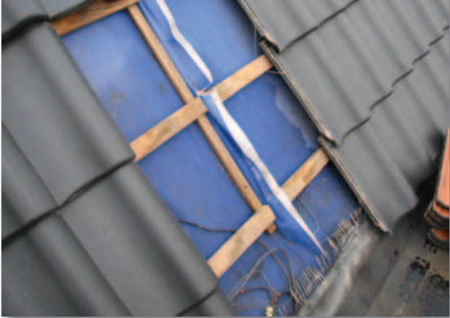
Lekkage onder de beugel van het zonnepaneel.
