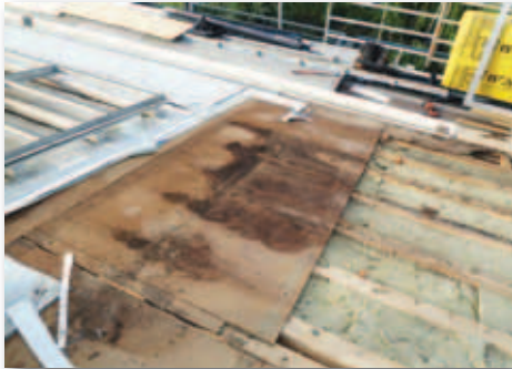
Figuur 5a: Schade aan dakbeschot als gevolg van condensatie door lucht- en damp lekkage vanuit de ankerloze bouwmuur.
