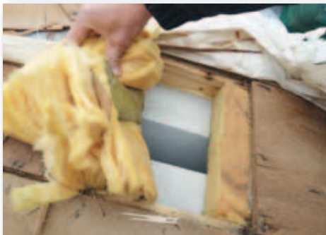
Figuur 5c: Bouwmuur is niet damp- en luchtdicht.
