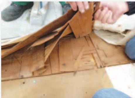
Figuur 5b: Plaatmateriaal ter plaatse van de bouwmuur is door vocht (vanuit de ankerloze bouwmuur) gedelamineerd.
