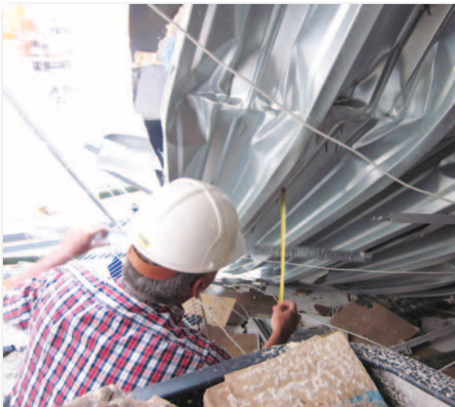
Nic-Jan Bruins bij het recent ingestorte dak van AH Winschoten (19 augustus 2013).
