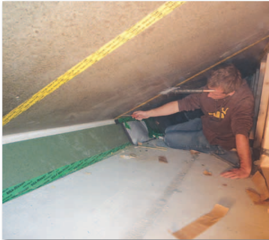
Kwalitatieve beoordeling muurplataansluiting (Emergo Houtconstructies) tijdens luchtdichtheidsmeting.
