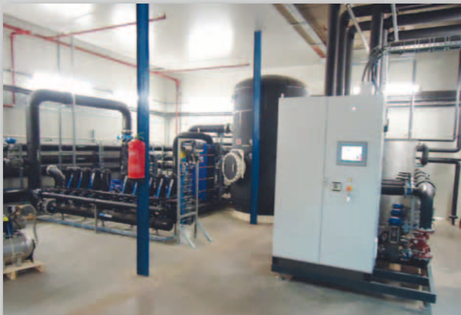
De fabrikant heeft onlangs geïnvesteerd in een nieuwe koelinstallatie
