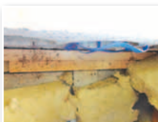
◀ Opname van bovenaf: isolatie los op plafond overstek en kanaalplaatvloer (kopzijde) ongeïsoleerd.
