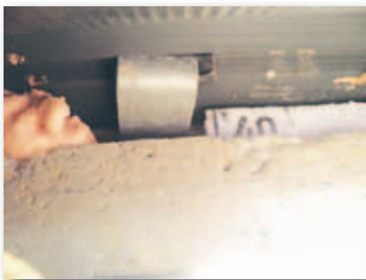
< 18. Afdichting van PUR tussen vloer en kozijn ontbreekt; tocht is een logisch gevolg.
