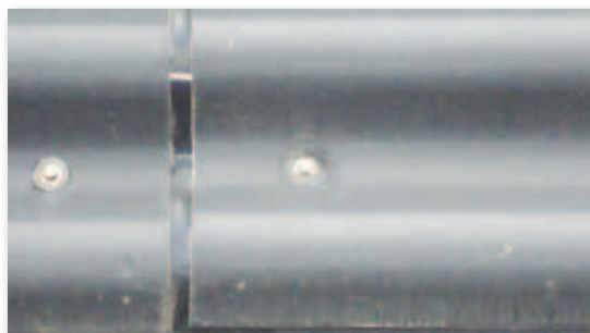
8. H3S set door golfplaat heen getrokken.
